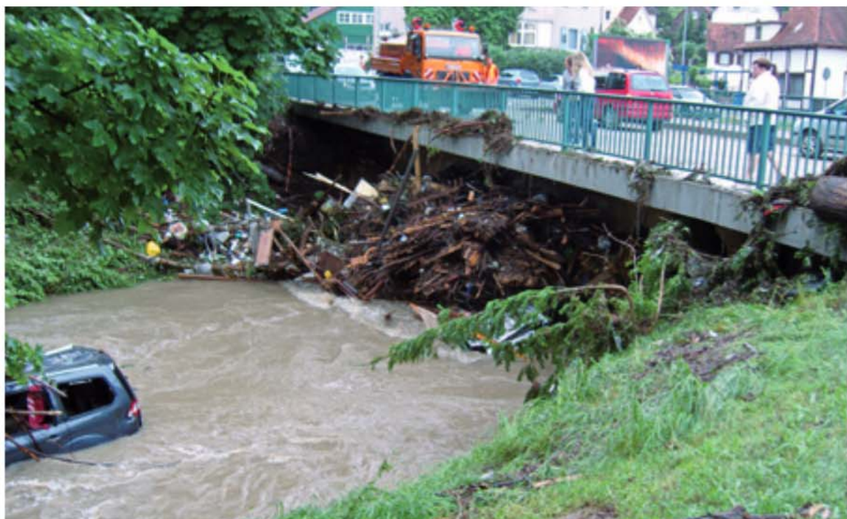
Abb. 16: Verklauung einer Brücke an der Starzel bei einem Hochwasserereignis im Jahr 2008
