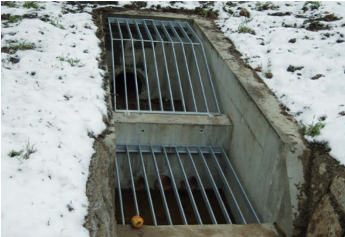
Abb. 32: Räumlicher Rechen am Einlauf zu einer Verrohrung
